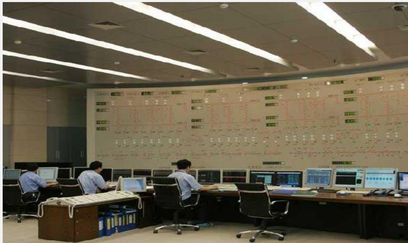
三峡水电站中控室
